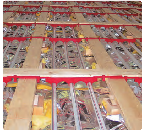
Oppervlak-elastische zwevende sportvloer met geïntegreerde Uponor verwarming voor zwevende vloer
