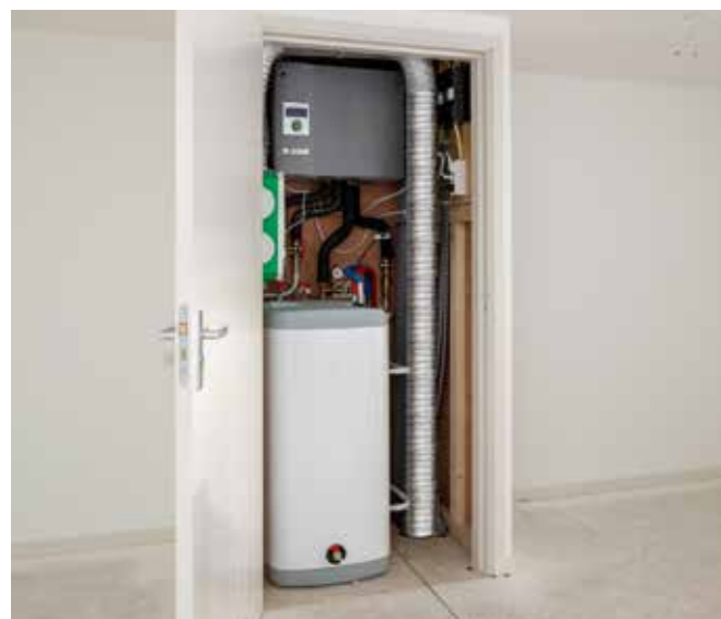
OPSTELLING IN DE METERKAST MET EEN ALPHA INNOTEC BOOSTER WARMTEPOMP.
