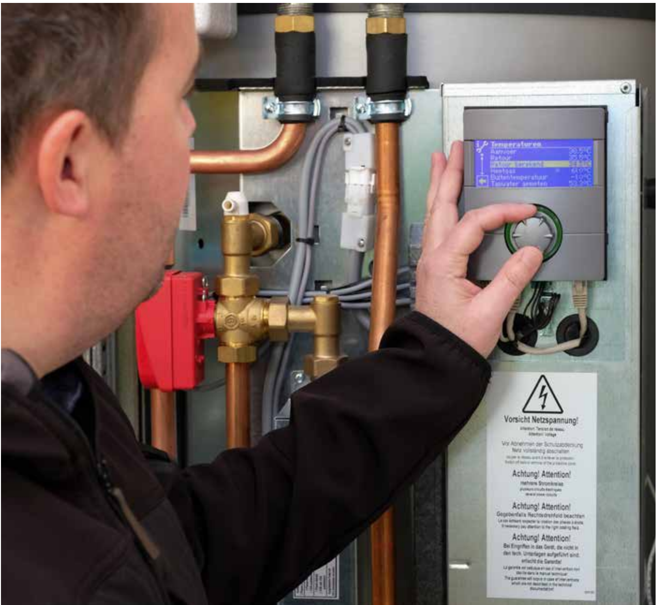
MARTIN LAAT ONS ZIEN DAT DE LWDV ENERGIE EFFICIËNT IS INGESTELD.
