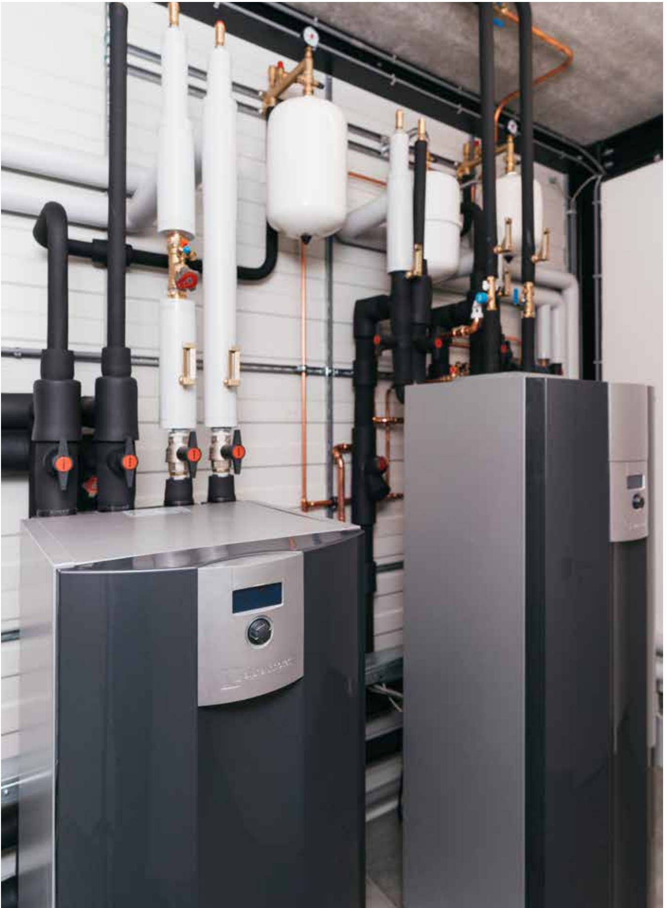
DE ALPHA INNOTEC ALTERRA SW232 BRINE/WATER WARMTEPOMP VOORZIET DE KANTOREN VAN WARMTE EN KOELING. DE ALPHA INNOTEC ALTERRA WZSV 122 BRINE/WATER COMBI-WARMTEPOMP VOORZIET IN TAPWATER EN VERWARMT EN KOELT DE BEDRIJFHAL.
