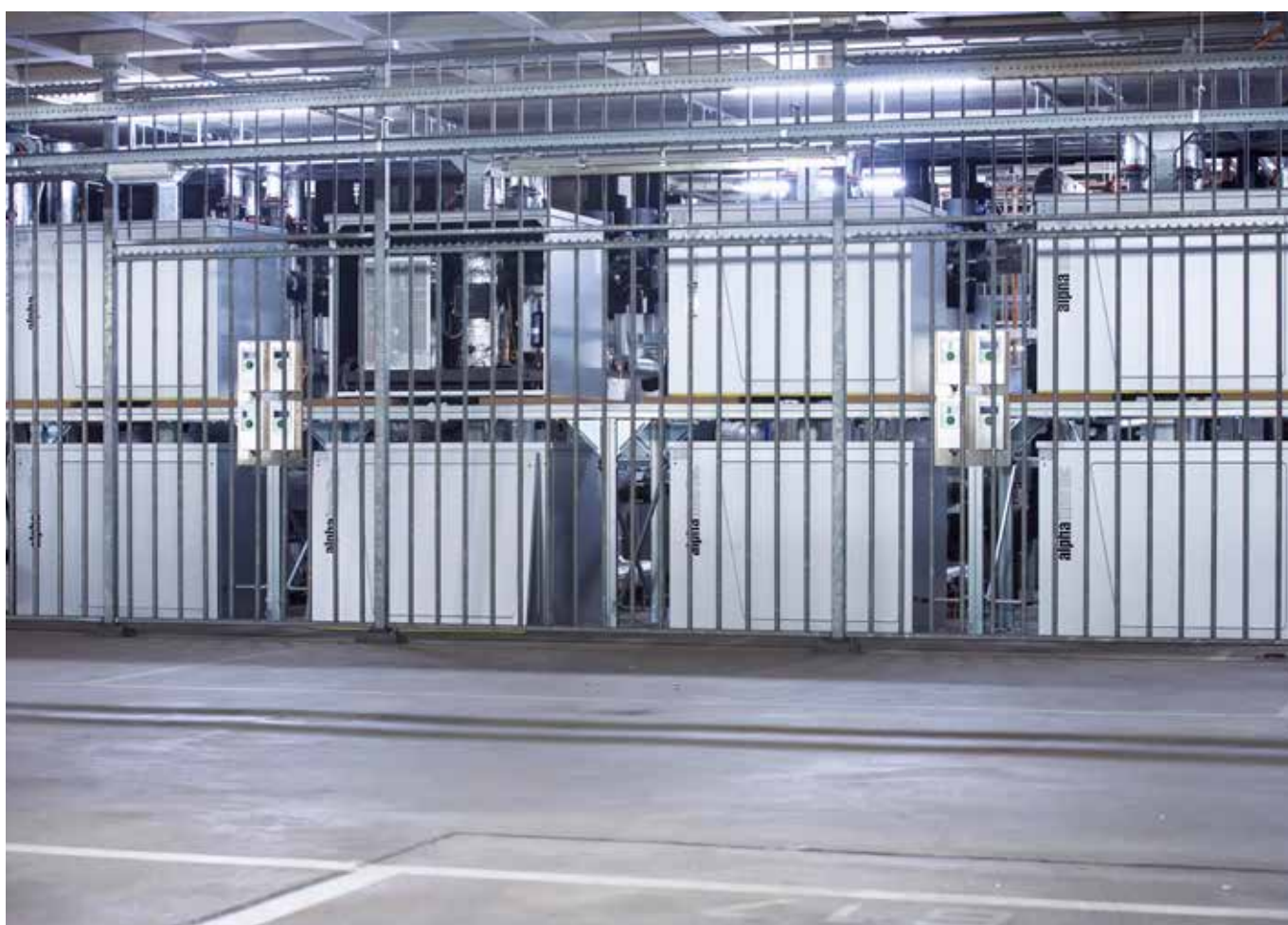
Opstelling met 8 alpha innotec SWP Professional warmtepompen, Mijnwater Heerlen
